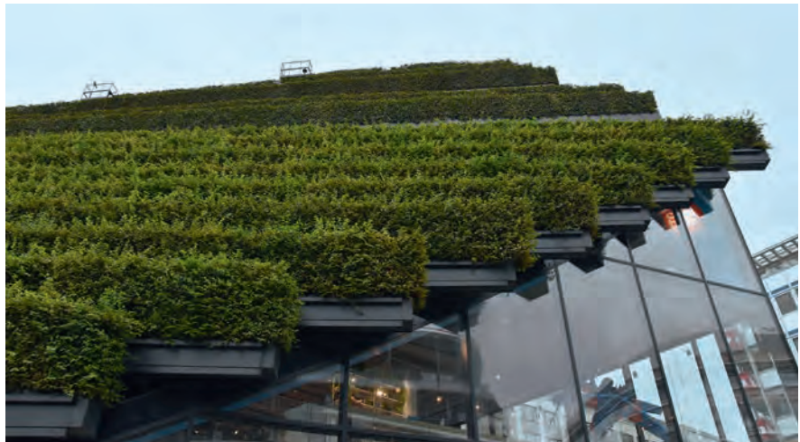
Bild 2: Beispiel einer Dach-/Fassadenbegrünung in der Stadt Düsseldorf Foto: Christoph Sager
