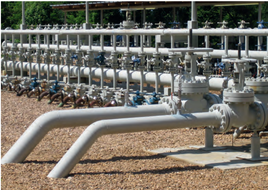
CO 2 -EOR in Mississippi, USA. Zusammenführung der Rohrleitungen von den Förderbohrungen zum Weitertransport zur CO 2 -Separation und Ölaufbereitung
