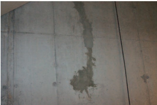
Bild 1. „Rohbaummäßige Spachteltechnik“ – nicht fachgerecht ausgeführte Betonkosmetik Fig. 1. „Rough finish concrete spackling“ – non-professional cosmetic surface treatment of concrete
