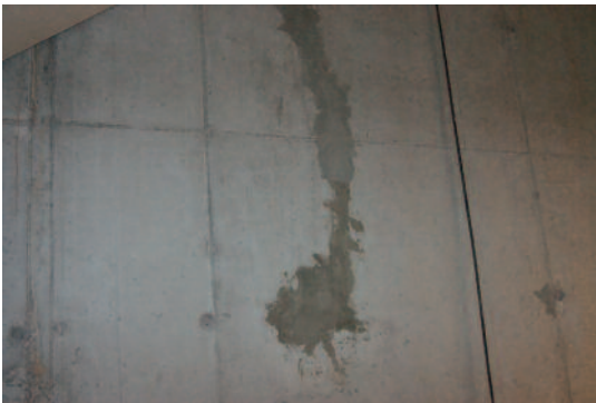
Bild 1. „Rohbaumäßige Spachteltechnik“ – nicht fachgerecht ausgeführte Betonkosmetik Fig. 1. „Rough finish concrete spackling“ – non-professional cosmetic surface treatment of concrete
